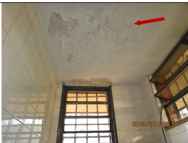
Mancha de umidade
