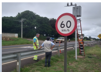
Verificação de radar, Tupã / SP
